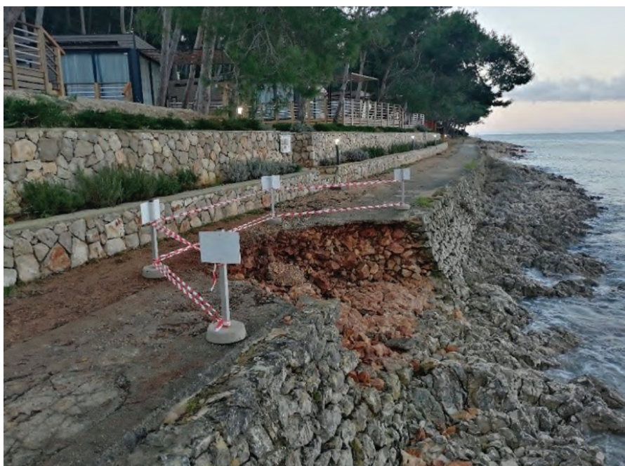
Slika 20. Oštećenje obalne šetnice u kampu Čikat, na području Grada Malog Lošinja (2019.)
