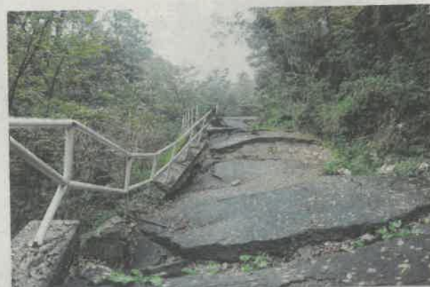
Još uvijek nesanimirano klizište na cesti Grohovo - Lopača
